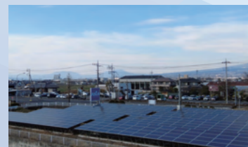
太陽光発電施設
